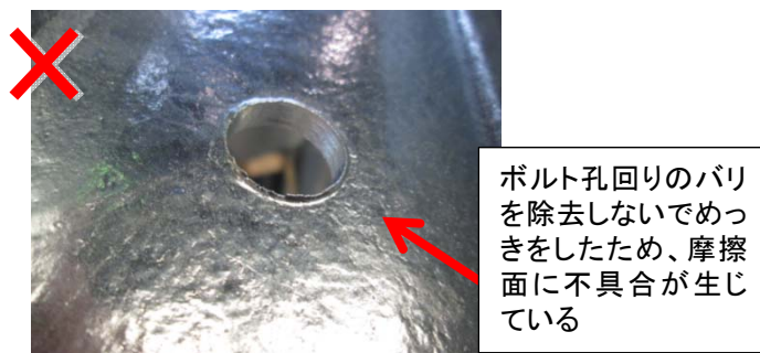
ボルト孔回りのバリ除去不良の例
