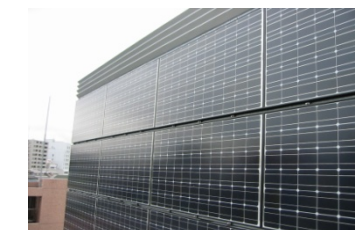
太陽光パネル
