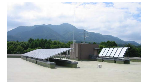
ソーラーパネル 左: PV 右: 温水パネル
