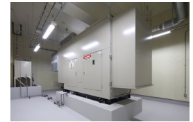
非常用発電機
