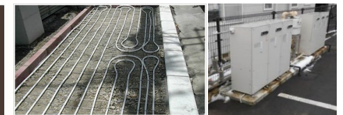
ロードヒーティング敷設、ボイラー
