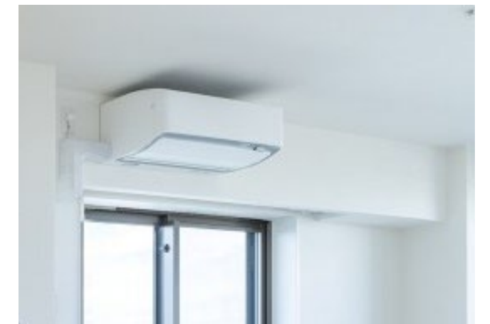
専有部_ルームエアコン
