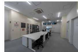
防災センター
