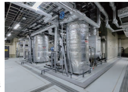
コージェネレーション設備
