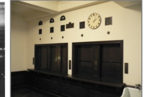
ダムウェーターはシャフトをダクトスペースに利用
