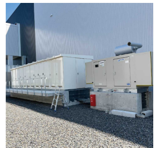
非常用発電機置場
