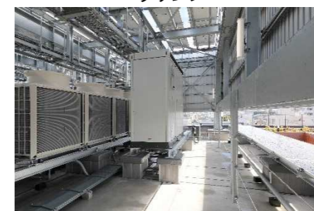
太陽光パネル・蓄電池
