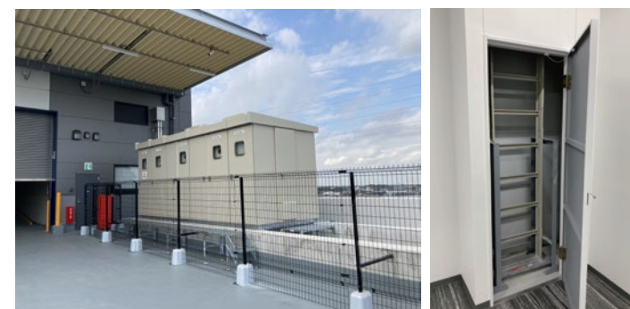
テナント用受変電設備とその将来用管路
