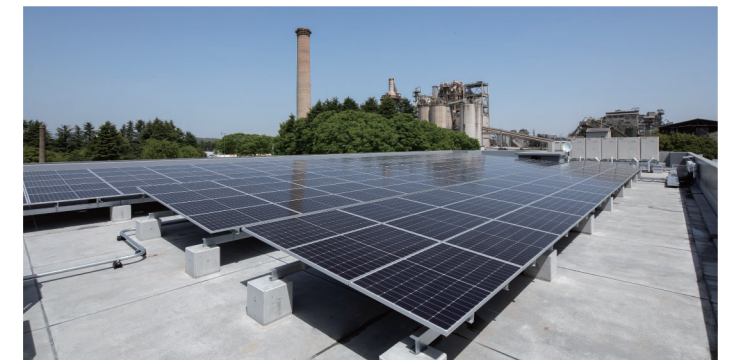
屋上 太陽光発電パネル
