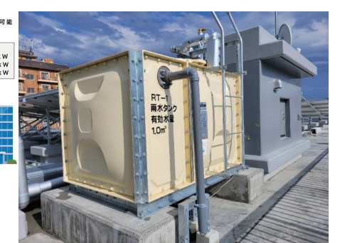
雨水貯留タンク
