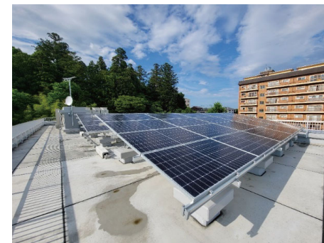
屋上に設置された太陽光パネル
