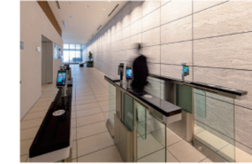
非接触型のセキュリティゲート
