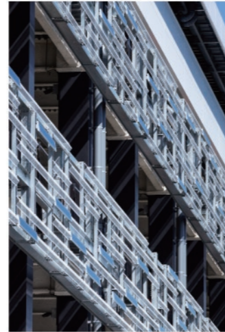
ソーラールーバー・有孔折板
