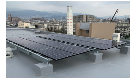
太陽光パネル
