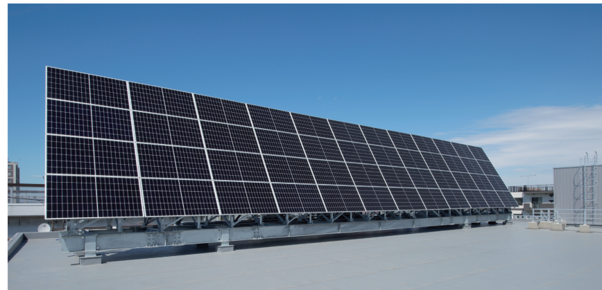
屋上に設置された太陽光パネル
