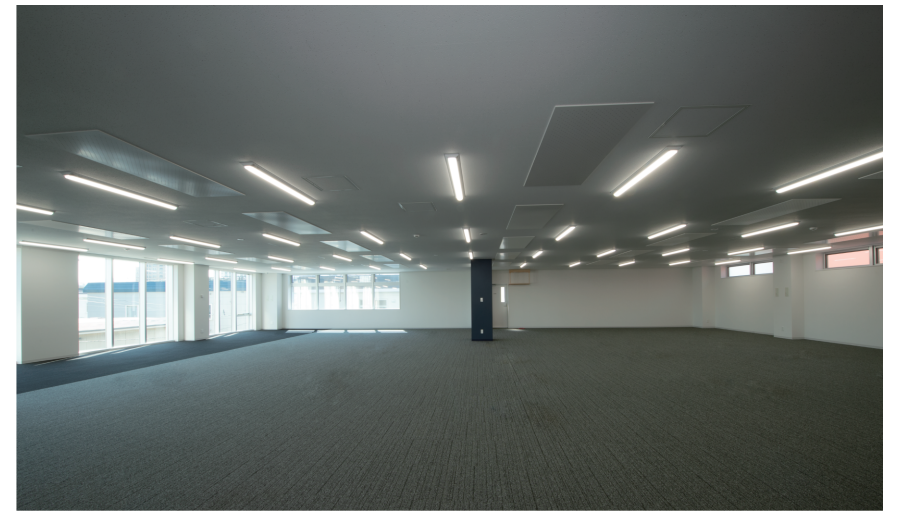
天井放射パネルが並ぶ3階事務室
