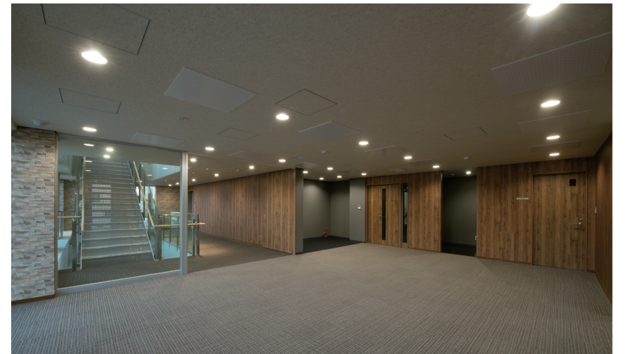
天井放射パネルが並ぶ2階ロビー。現在はPCモニターが設置されている
