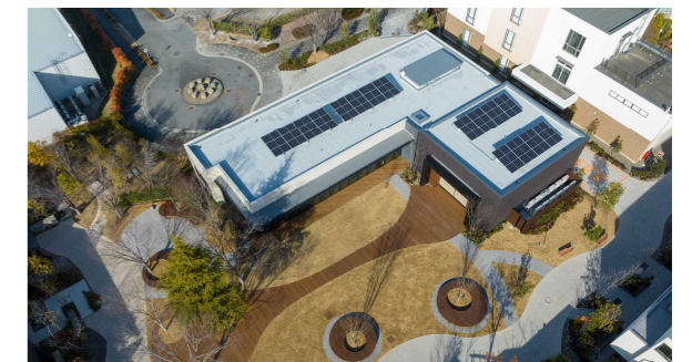
屋上太陽光発電パネル
