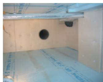
地下ピット機械室
