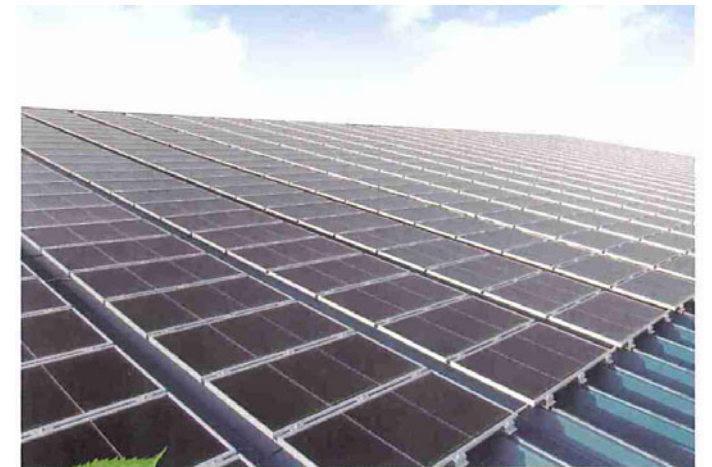
工場屋根に設置された太陽光発電（200kW）
