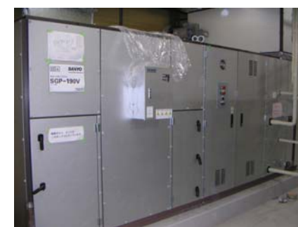
外気処理空調機 (GHP直膨コイル組込)
