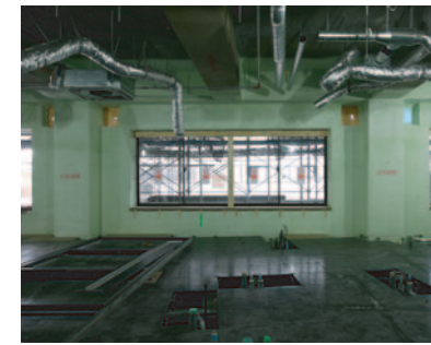
躯体と分離した設備
