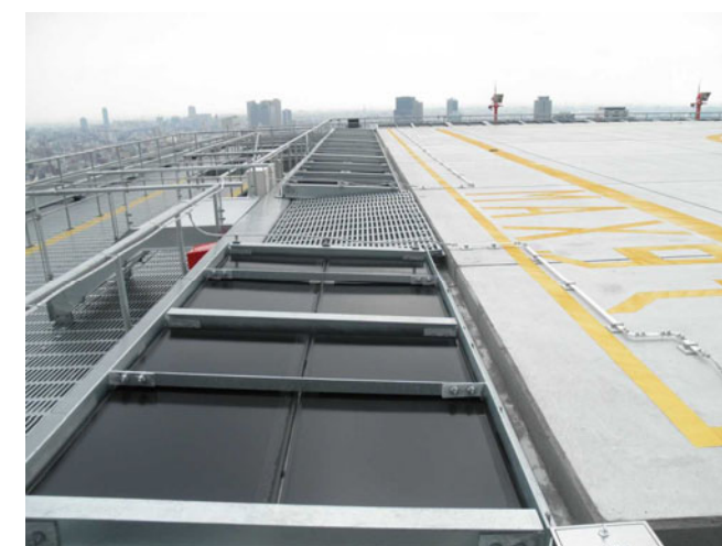
太陽光パネルの設置と雨水利用
