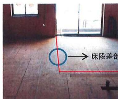
写真15 ②段差部状況
