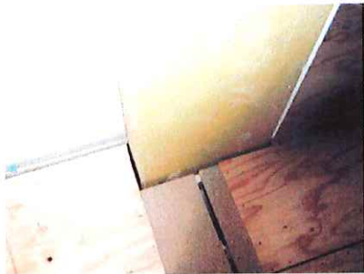
写真9 ①③壁・パチ隙間状況
