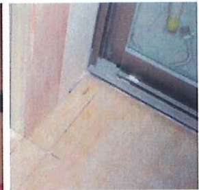
写真11 ⑤サッシ額縁下隙間状況
