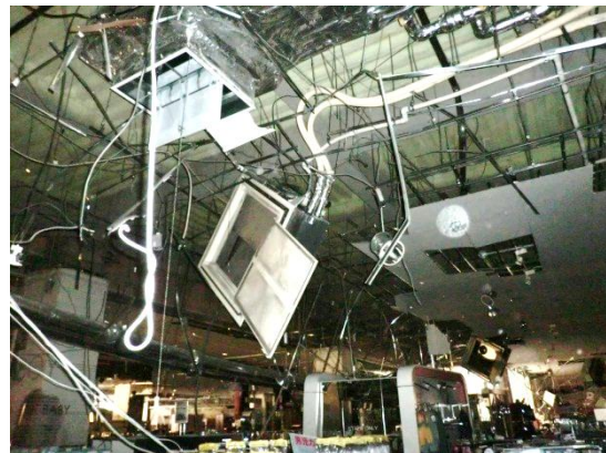
写真2 天井・設備の罹災状況
