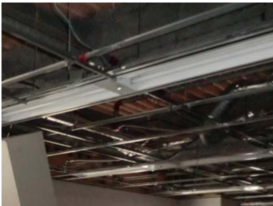
写真1 天井の罹災状況
