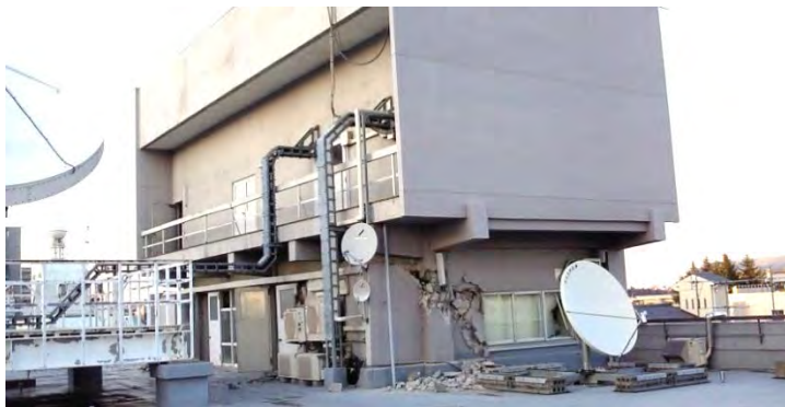
塔屋 被災直後
