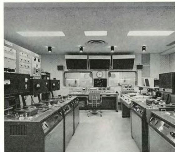
ラジオ主調整室 Main control room for radio
