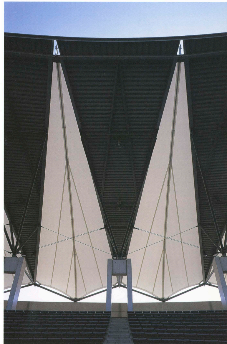
屋根の見上げ 膜はフッ素樹脂コーティングガラス繊維布 Upward view of the PTFE coated glass fiber fabric membrane roof.
