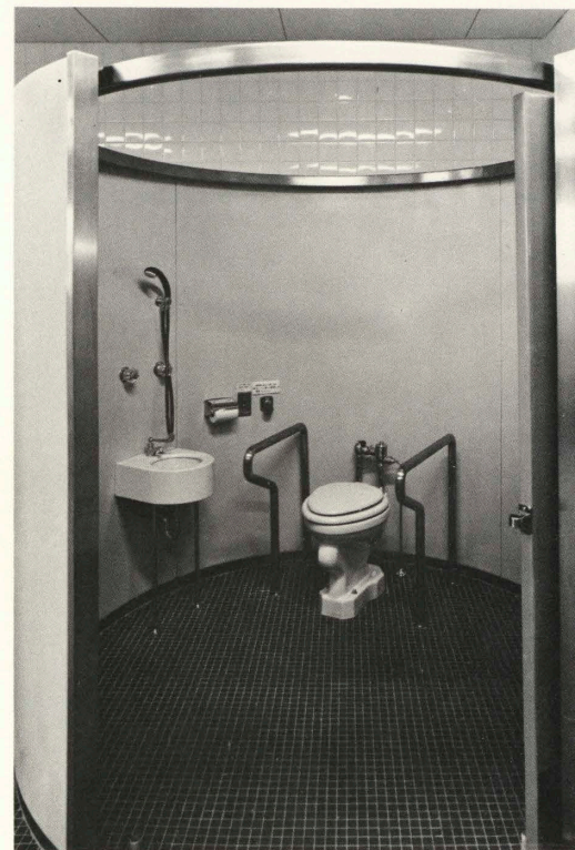
円型便所ブース Cylindrical toilet booth.
