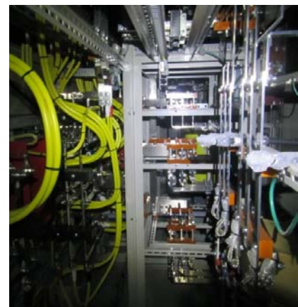
受変電設備内部の例
