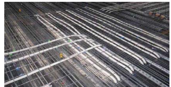
合成スラブデッキ電気配管不具合事例 (50φと配管が太く、鉄筋、デッキと接している)
