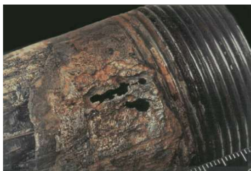
図-2 電食による配管の破損例
