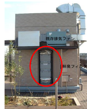
小規模タイプ対応例 (某シルバーマンション共用厨房用) Q=1,600m 3 /hr
