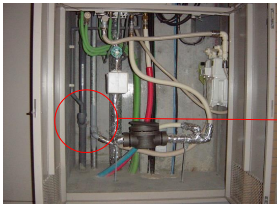
給湯器下部配管状況
