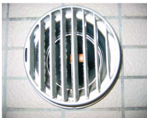
写真-1 不具合のあったベントキャップの設置状態
