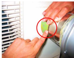
写真-4 FDと差込口の隙間1mm程度有り
