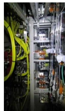
受変電設備内部の例
