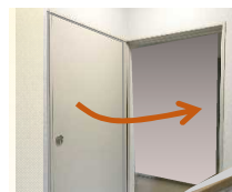
防火扉作動試験
