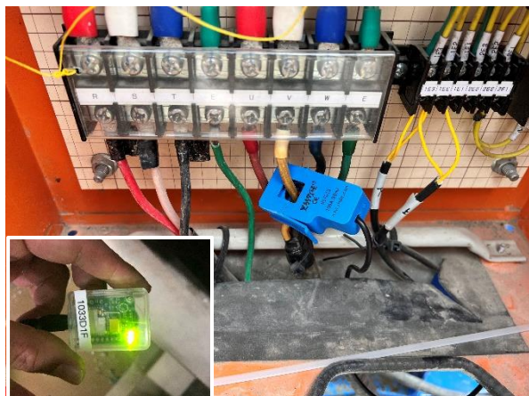
写真2 電力センサー設置状況
