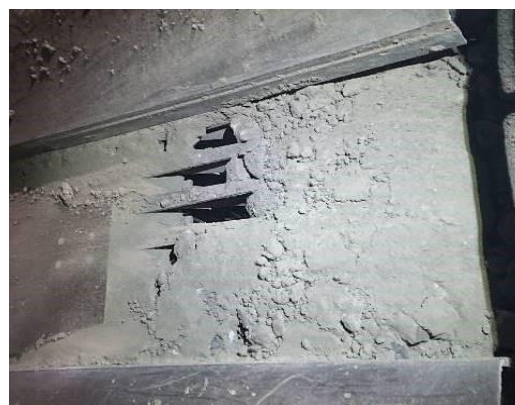
写真 2 閉塞したクラッシャー内部状況
