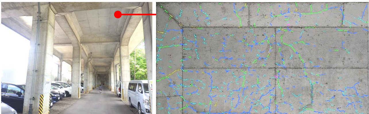
図2 点検コストを比較したラーメン高架橋の外観と t.WAVE によるひび割れの検出結果
