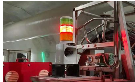
写真6：異常時警報状況
