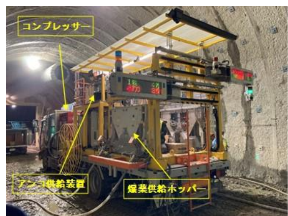
写真 1 遠隔装填装置
