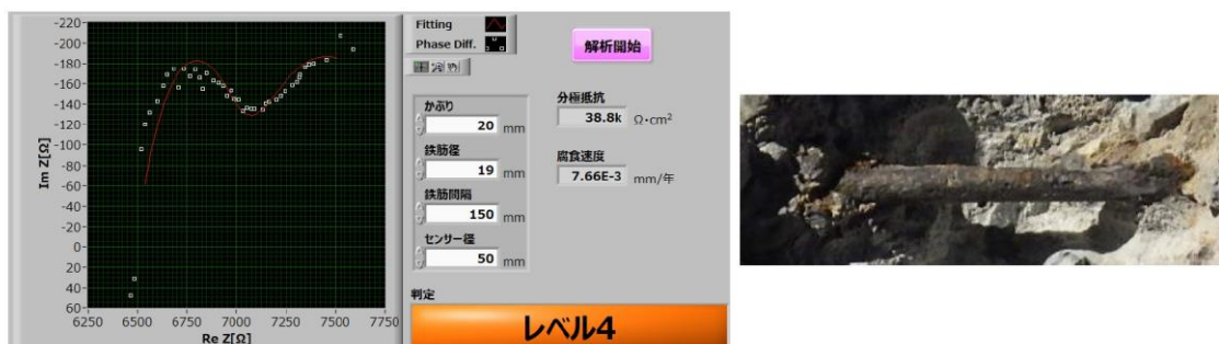
図2 測定結果の画面と測定箇所の鉄筋状態
