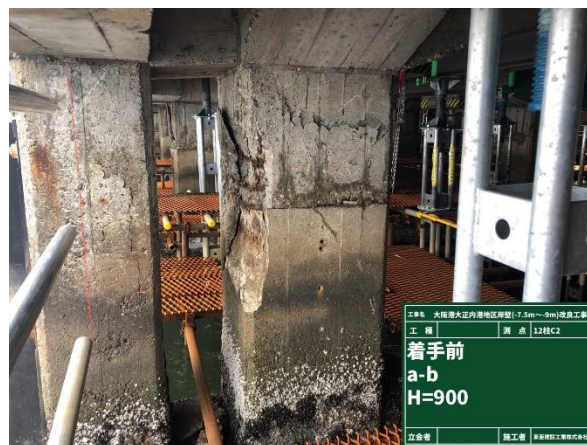
劣化した栈橋の支柱
