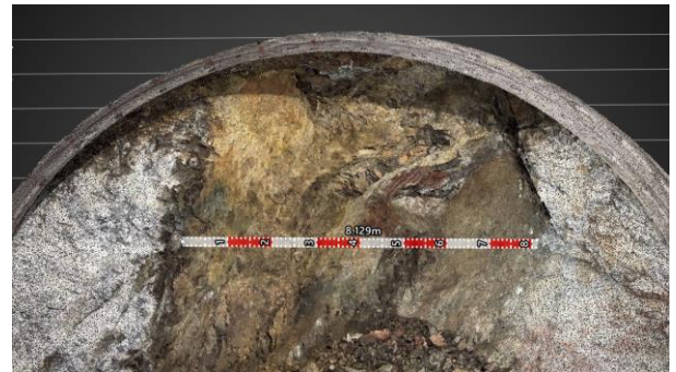
図-4 崩落幅を計測
