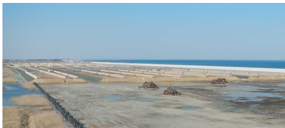
山寺須賀地区の林野庁仙台森林管理署の海岸防災林造成盛土に再生資材を運搬しました
