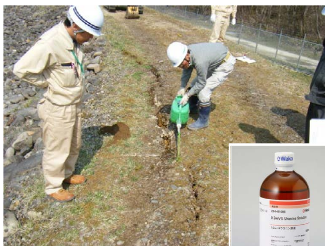
クラック進展確認状況
