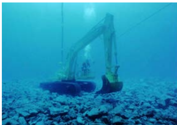
水中バックホウによる捨石均し状況 (写真は沖縄地区での状況)
