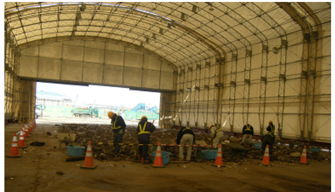
写真-11 屋内選別設備
