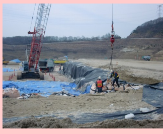
小鶴沢処理場での飛灰の積下し状況
