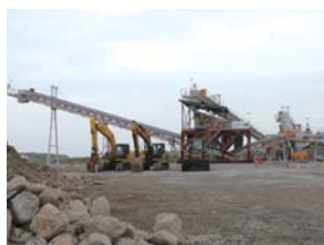
コンクリート破砕設備
