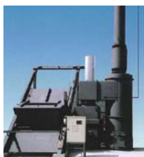
バイオマスボイラー
