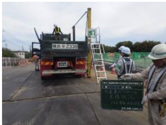
写真-10 昇降設備
