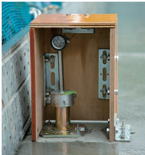
黒いボックスに入っているのが自動測量機・トータルステーション(写真上)。各所に設置されたミニプリズム(写真下)に射光し、その反射から橋面高さの測量・記録・管理を行う。
