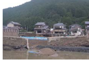
災害状況全景写真 擁壁が堤内側に滑动・転倒、輪中堤が決壊 23.9.12
