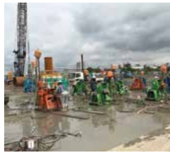
地下水圧対策の地盤改良工は、薬液注入用の機械を全国から約100台集めて施工。工期の遅れを最小限に止めた。
