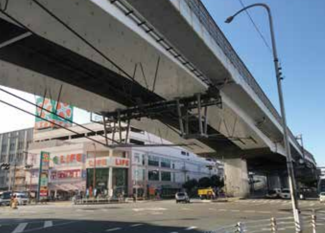
施工前の橋梁は外ケーブルによる補強で垂れ下りの進行を防いでいた。
