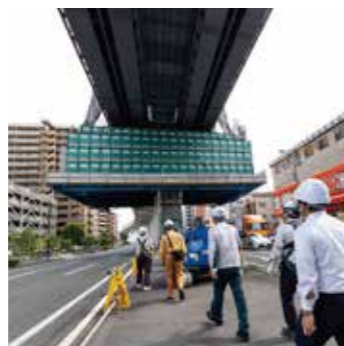
工事直下の道路(内環状線)の中央分離帯を通り、施工現場へと向かう。
