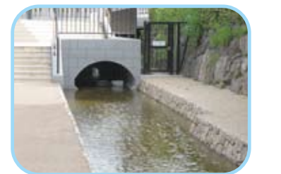
⑥ 導水は下水放流渠に 流れこんでいます。
